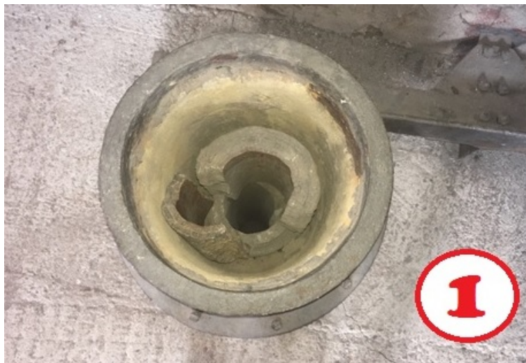
Abbildung 22: Offene Rohrleitung zur Wasserführung im Innenbereich
