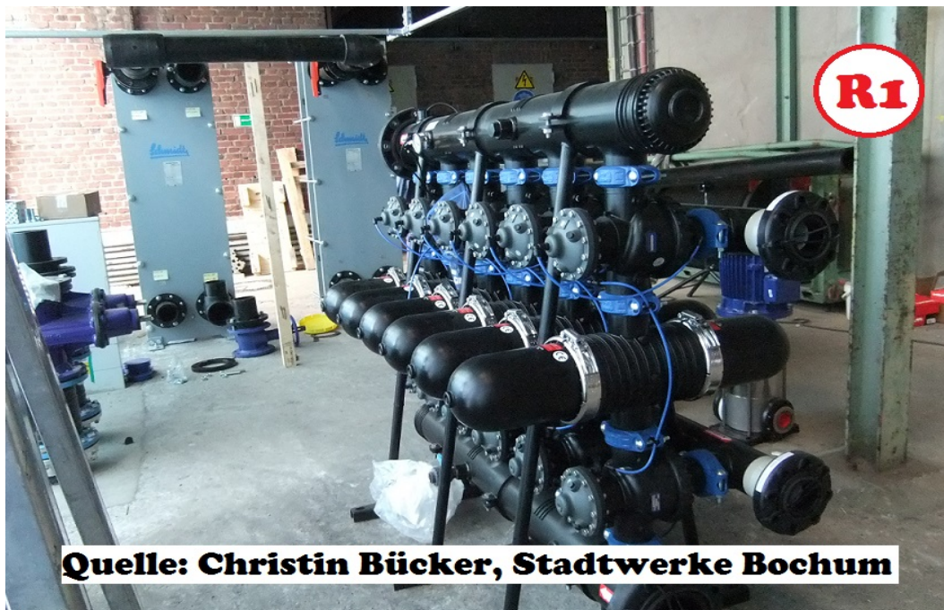
Abbildung 32: Filteranlage der geotherm. Anlage Robert Müser
